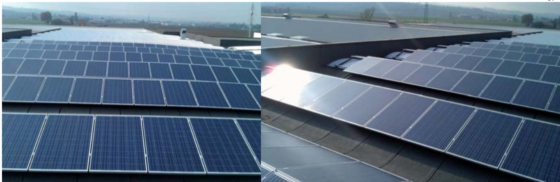
Impianti realizzati su edifici privati
